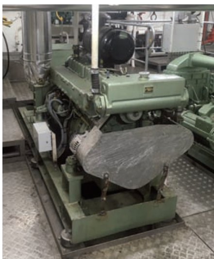
➤ Cámara de máquinas.
